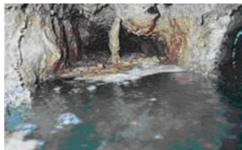
油が固まった下水道管
